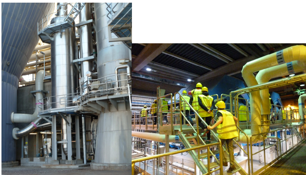
Bilder från rundtur i fiberlinjen. Till vänster reboilern, till höger på väg till DD-tvättar.
